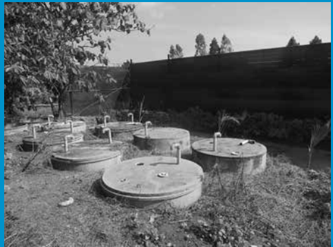
ถังบำบัดน้ำเสีย
